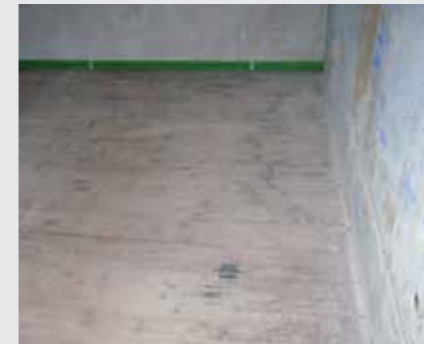
Suché poterové dosky a staré drevené podlahy – nebezpečenstvo vibrácií a priehybov.
